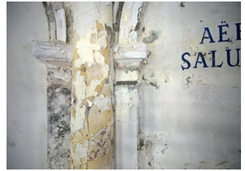
Abb. 3: Schadensphänomene aufgrund von Feuchtigkeit und Salzausblühungen an der Säule zwischen der Südost- und Südwand. (M. Jegge 2022)
