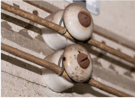
Abb. 1: Isolierrollen aus Porzellan mit Gummiaderleitung, ca. 1920, Castello Trefogli Torricella/TI (André Lison, 2024)
